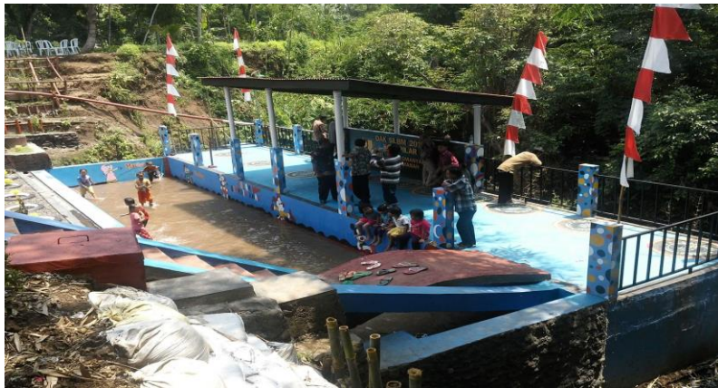
Gambar 3.9 IPAL Komunal DAK Kabupaten Purbalingga Provinsi Jawa Tengah 2015
